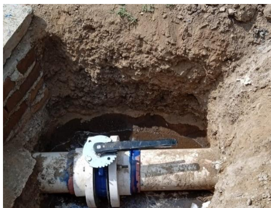
Figura 25. Válvula de influente en el rastro de Tuxpan
