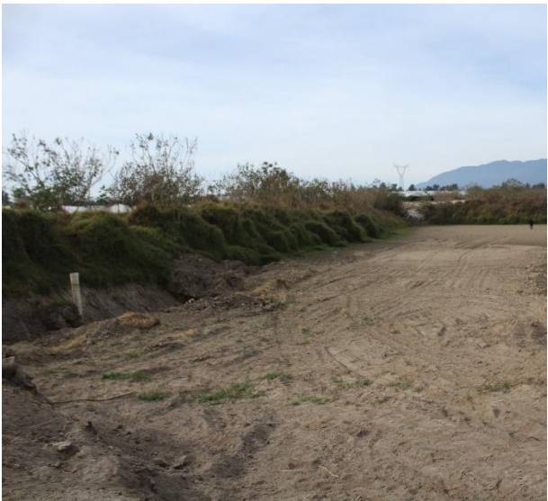
Figura 53. Estructura para captación de escurrimientos pluviales.
