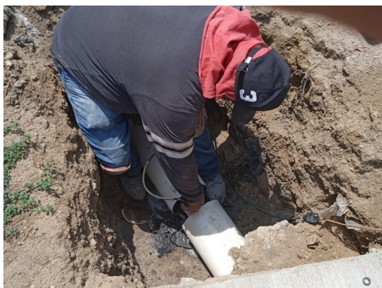
Figura 24. Conexiones biodigestor rastro Tuxpan
