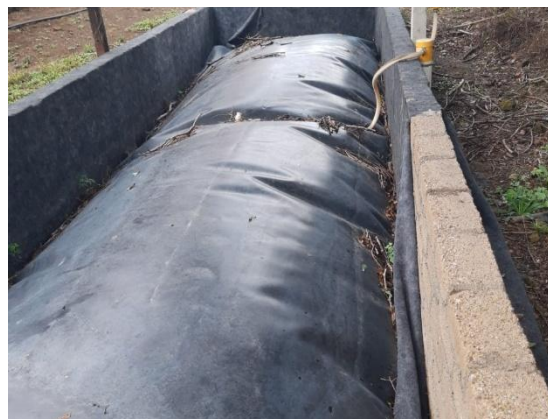
Figura 27. Biodigestor de 20m 3 rastro de Tuxpan activado.
