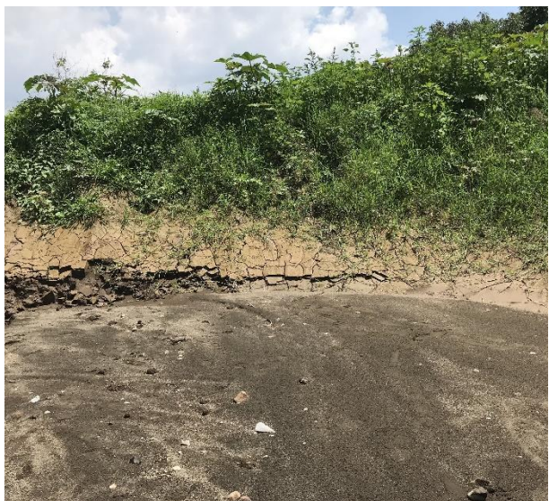
Figura 57. Presa compactada de tierra para controlar la velocidad de los escurrimientos.
