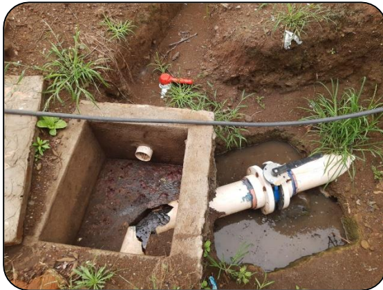
Figura 19. Conexiones biodigestor con fugas de rastro Tuxpan.
