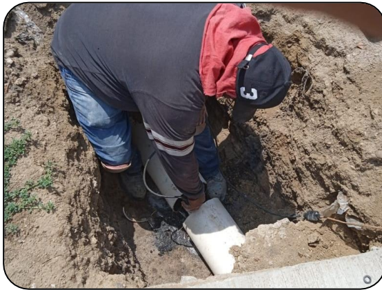
Figura 2. Conexiones biodigestor rastro Tuxpan
